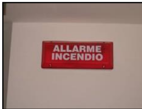
Pannello ottico acustico allarme antincendio
