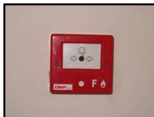
Pulsante di azionamento manuale allarme antincendio
