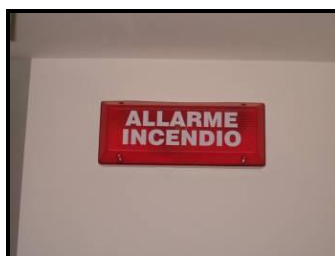
Pannello ottico acustico allarme antincendio
